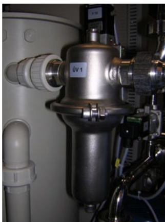
Generator promieniowania ultrafioletowego (UV) w pętli wody po odwróconej osmozie gwarantuje jej jałowość
